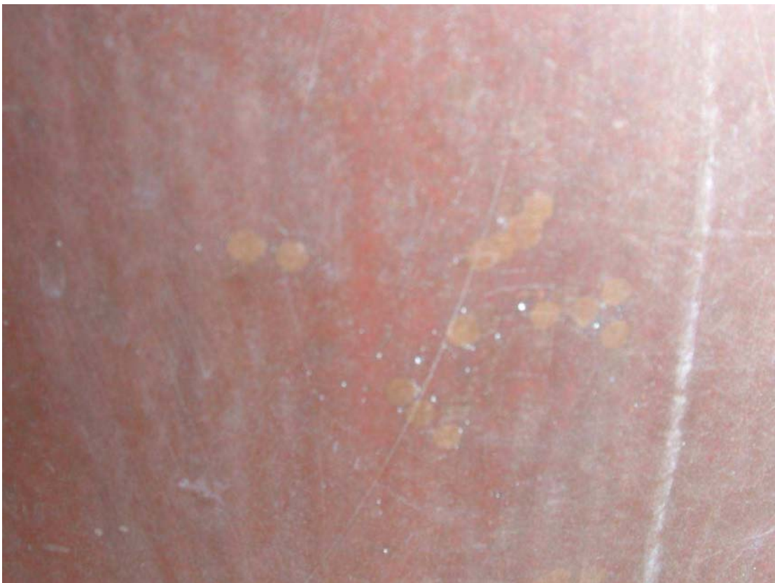
Figure 10: Reparaturen der Oberfläche mit Gewindestangen unterscheiden sich farblich.
