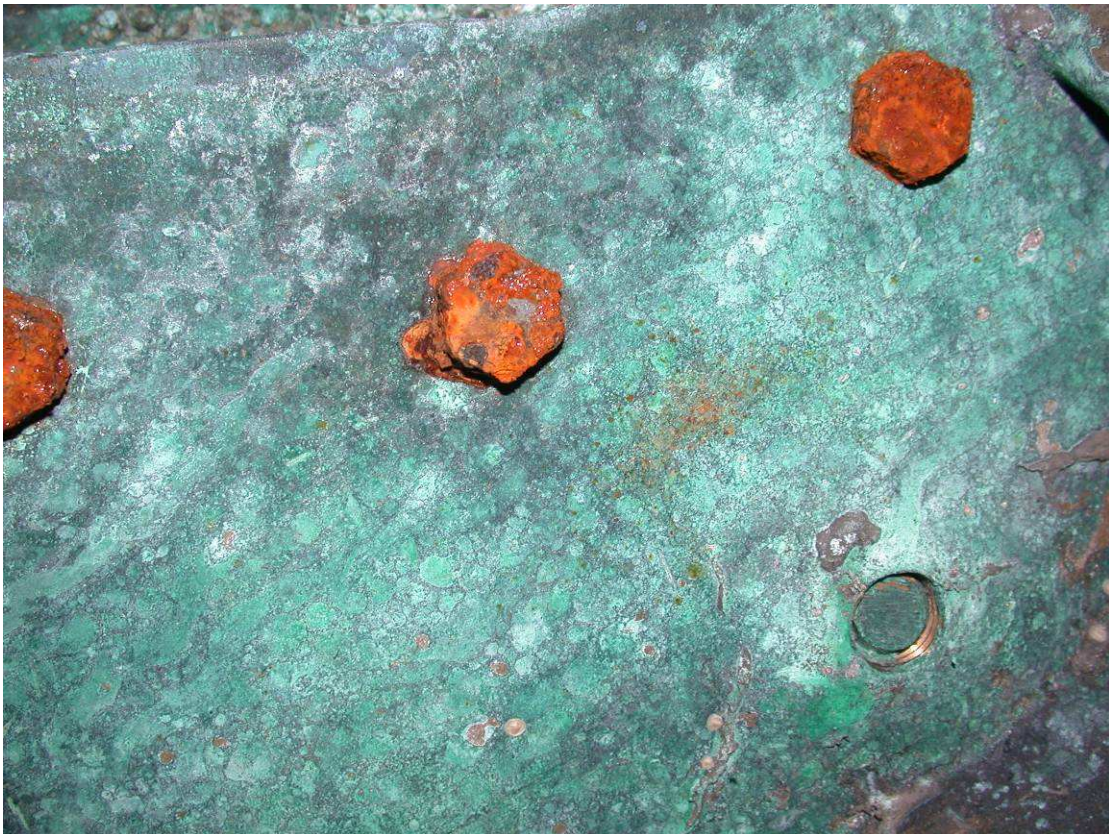
Figure 18: Innenansicht: Detail der korrodierten Schrauben
