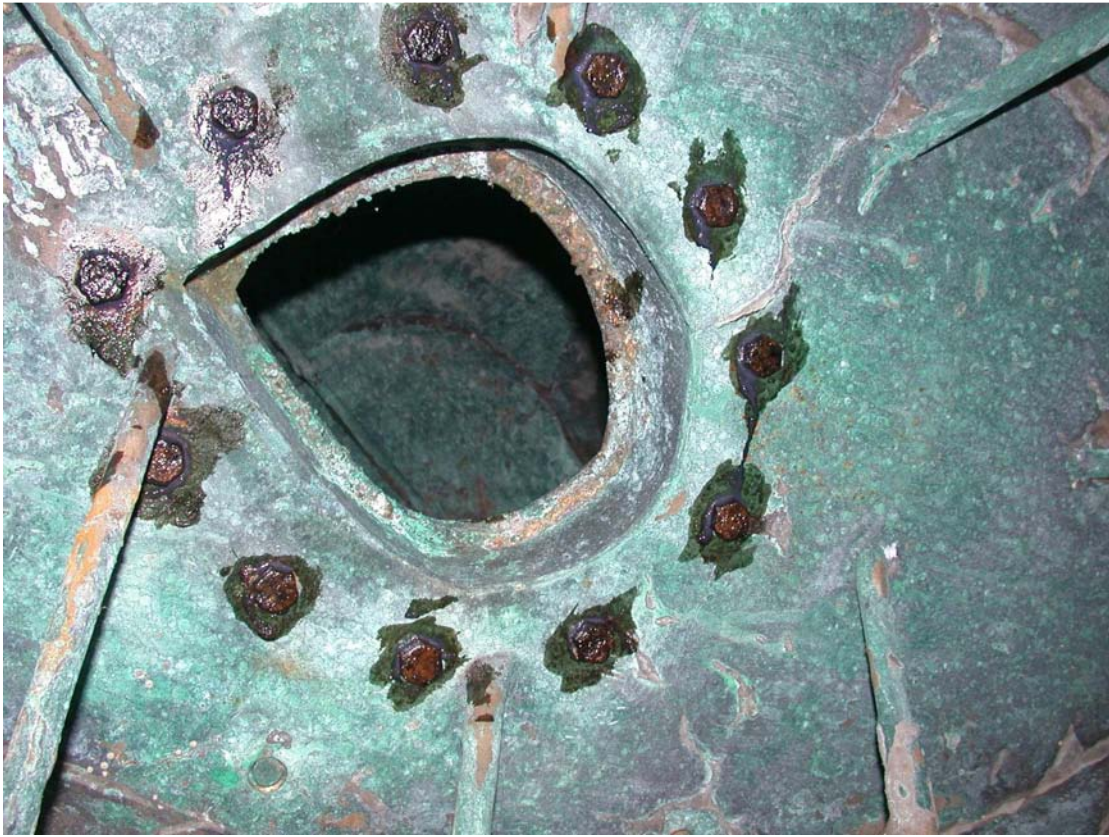
Figure 28: Innenansicht: Behandelte korrodierte Verschraubung.
