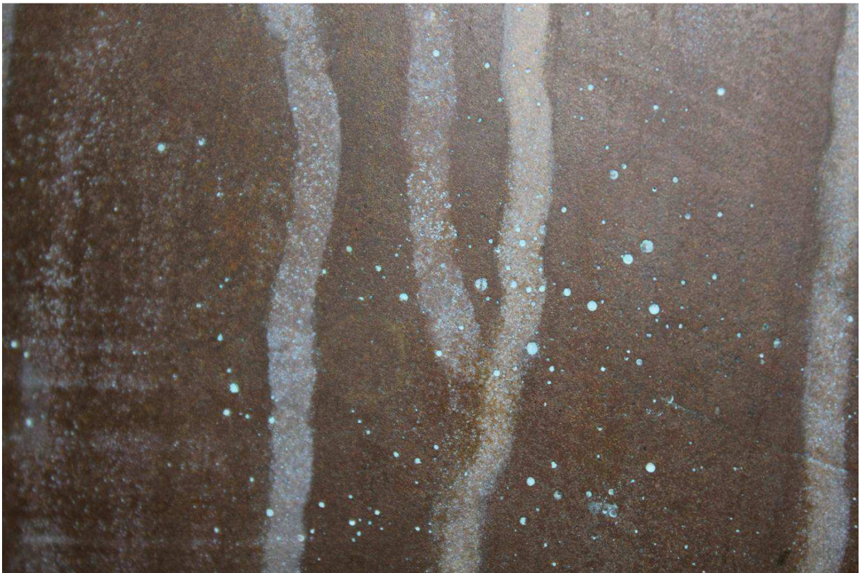
Figure 13: Korrosionspunkte in der Oberfläche.
