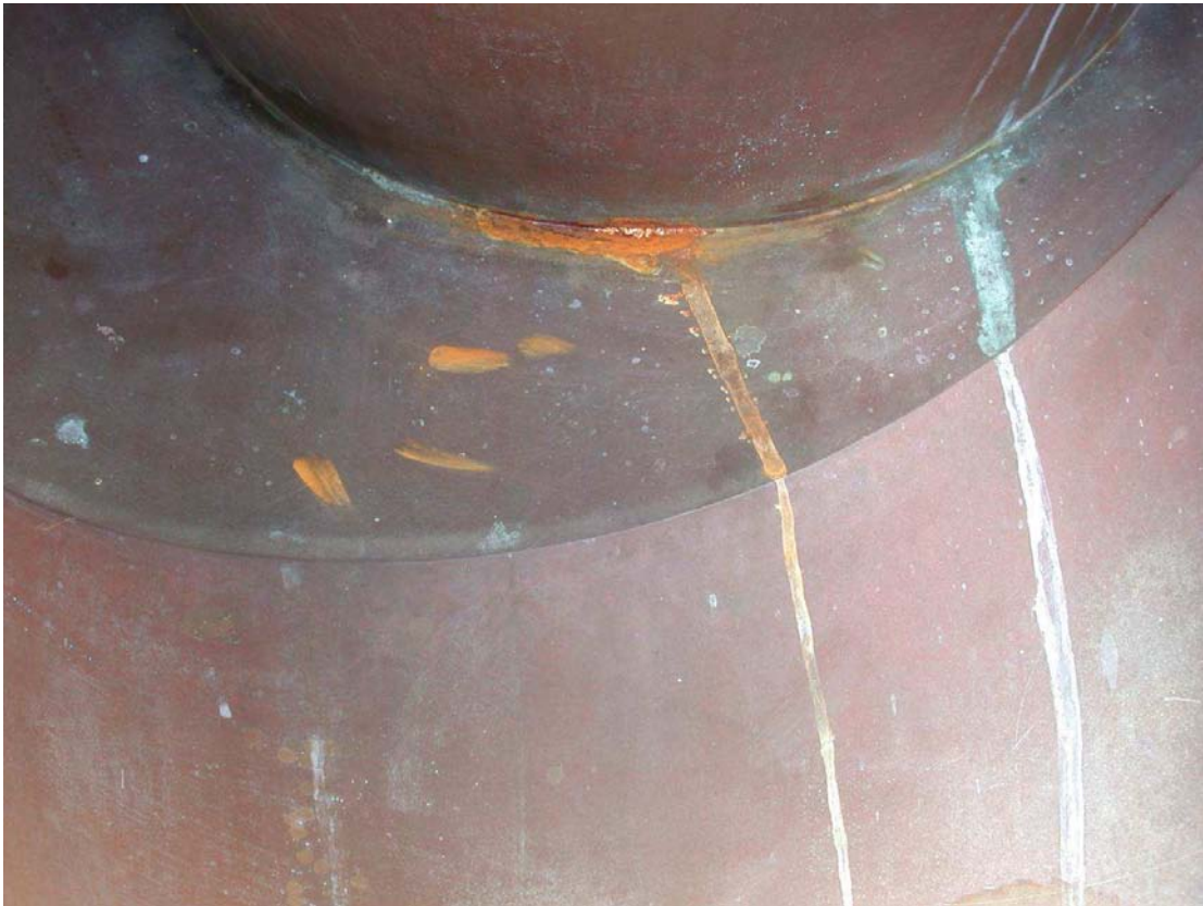
Figure 6: Laufspuren von Eisenkorrosion und Bronzekorrosion.
